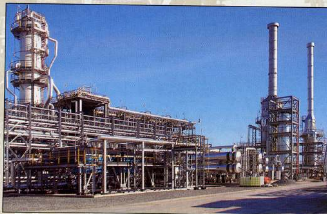
Установка стабилизации и очистки конденсата Тарасовского ГКМ, РФ, ЯНАО, г. Губкинский
