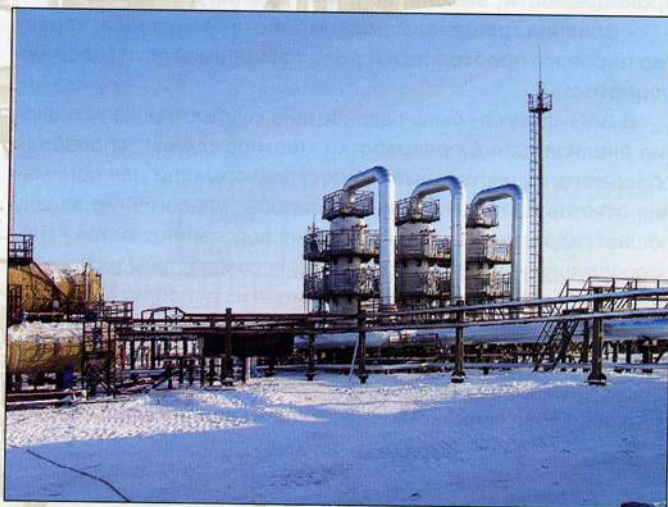
Установка комплексной подготовки газа Находкинского МР
